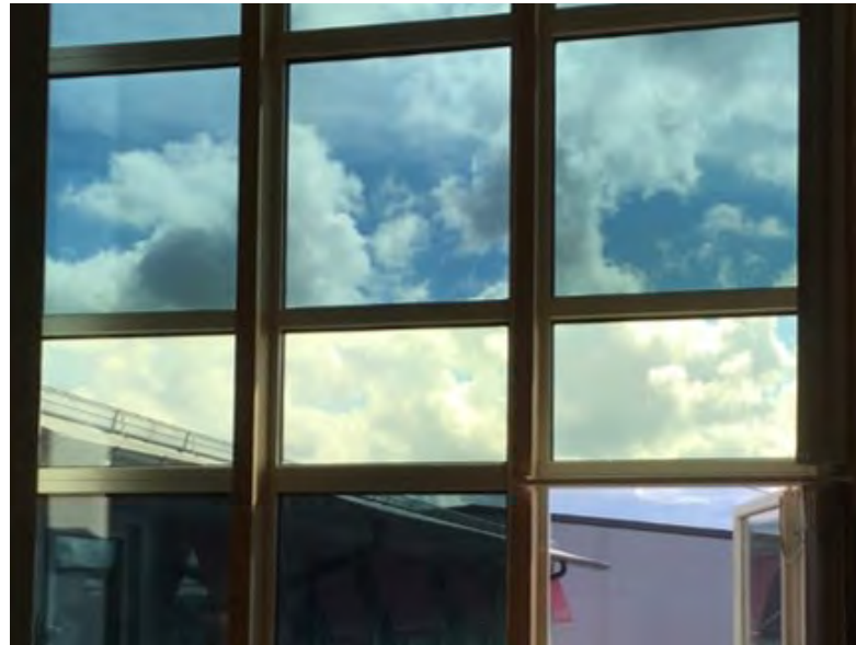
Wirkung von elektrochromen Fenstern am Beispiel eines Zimmers im Krankenhaus Nikaia Agios Panteleimon, Griechenland
